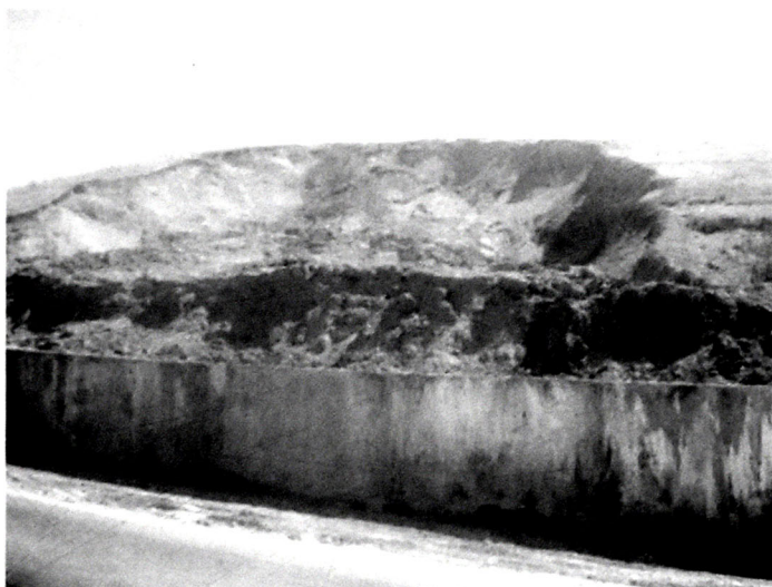
Рис.1. Оползень на 106 км дороги Баку-Шамаха
