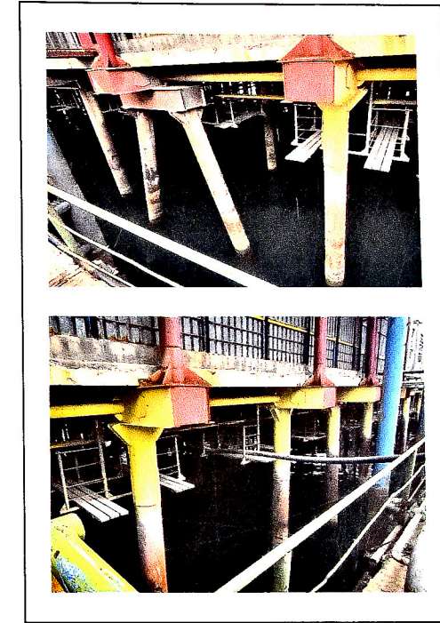
Şəkil 4. Neft Daşları yatağında Yeni QTIES meydançasının tikintisi layihəsində monolit dəmir-beton düyünlərin tətbiqinə dair fraqmentlər
