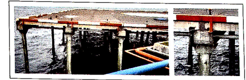
Şəkil 3. Neft Daşları yatağında helikopter meydançasının yenidən qurulması layihəsində monolit dəmir-beton düyünlərin tətbiqinə dair fraqmentlər
