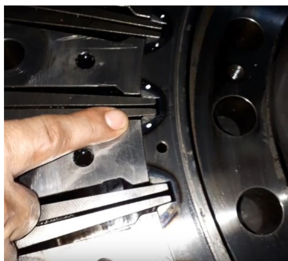
Рисунок 10. Оценка технического состояния пружин осмотром
