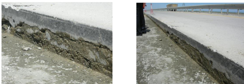
Şəkil 3. Qruntun nəmlənməsi səbəbindən sementbetonun dağılması
