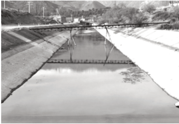
Suqovuşan su anbarından su alan Magistral kanal
